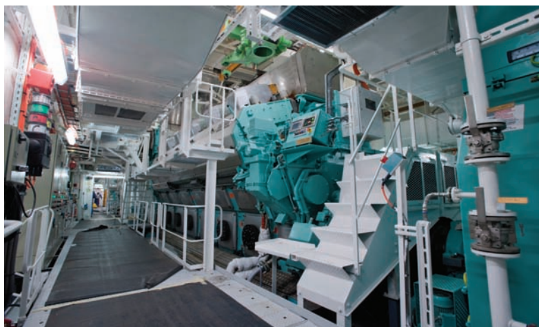
Motor principal en la cámara de máquinas de un buque.
