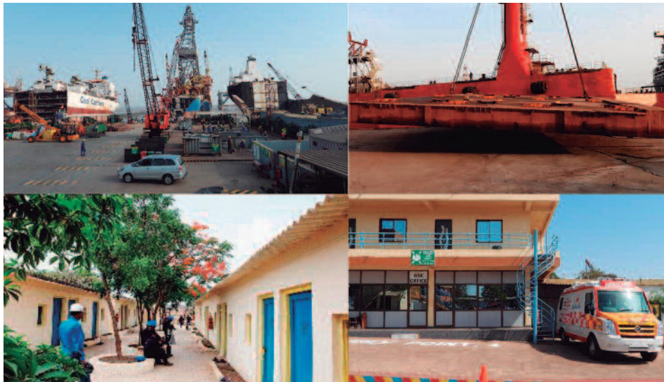
Mejoras en las instalaciones de desguace de la India que han obtenido el SoC: suelos impermeabilizados, grúas, alojamiento para los trabajadores y servicios médicos. Fuente: ECSA - Visita a varias instalaciones de desguace de la India - Febrero 2019
